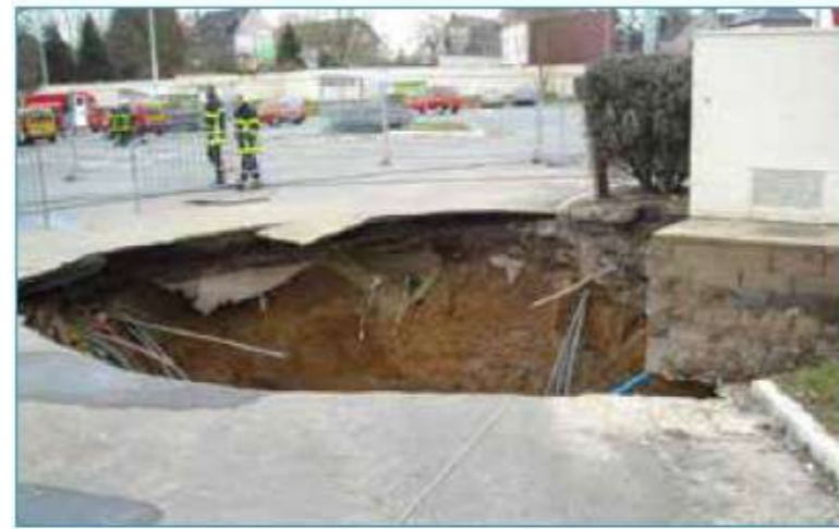
Illustration 1.27 : Effondrement de chaussée, Bapaume (62) [crédit BRGM, sd]
